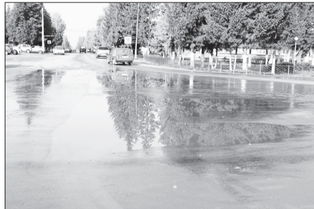
● Так выглядит подъезд к селу Красные Четаи после дождя.
